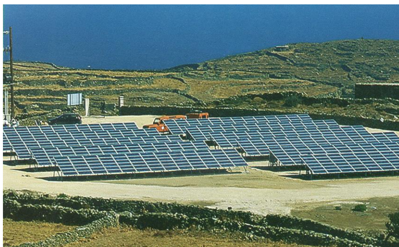
Slika 03. Solarna elektrana snage 60kWp na grčkom ostrvu Sifnos
