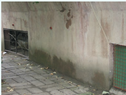
Сл. 6. Последице подизања нивоа подземних вода Fig. 6. Repercussions of the subterranean water level rise
